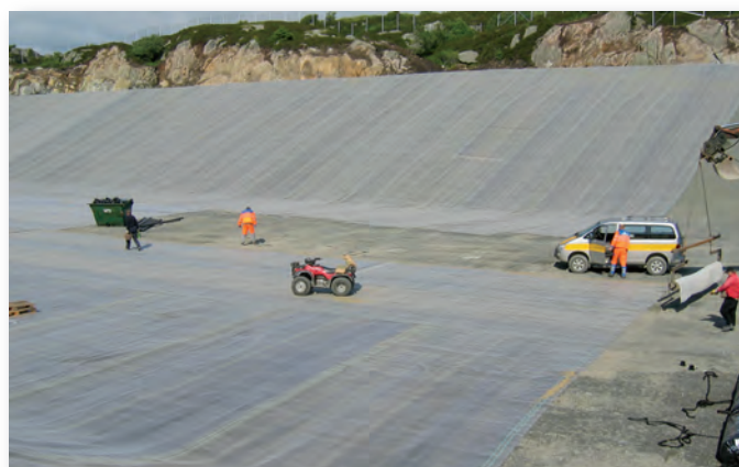
Bentonittmembran som bunntetting av avfallsdeponi
